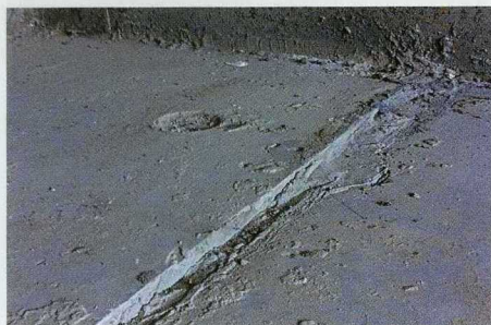
Сборные перекрытия. Перепад на стыке 30 мм и заусенцы
